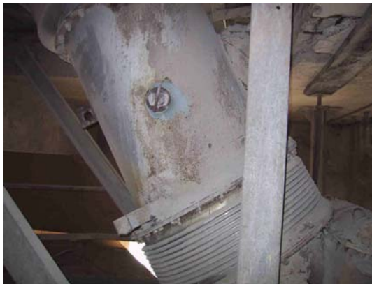
[ Cyclone에 설치된 Cardox Sockets ]
